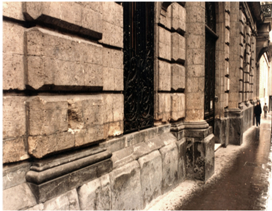
Segni di degrado dovuto all'umidità: particolare di un edificio storico
