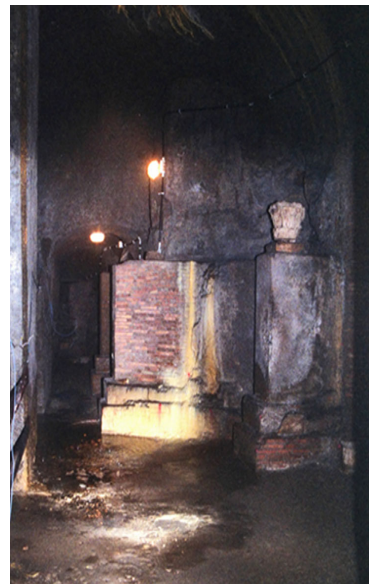
Teatro romano di Ercolano: degrado causato da infiltrazioni d'acqua
